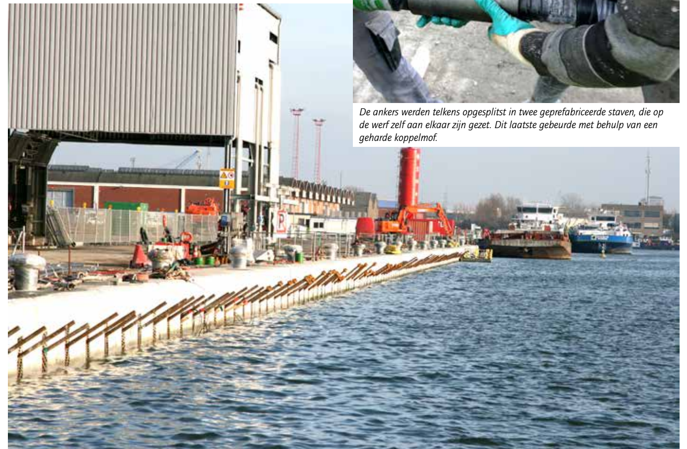
De stabiliteit van de verdiepte kaaimuurconstructie aan het Vierde Havendok wordt verzekerd door 154 staafankers met een nominale diameter van 75 mm (75 TR) en lengtes tussen 29,5 en 33 meter.
