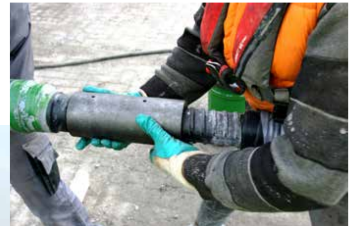
De ankers werden telkens opgesplitst in twee geprefabriceerde staven, die op de werf zelf aan elkaar zijn gezet. Dit laatste gebeurde met behulp van een geharde koppelmof.
