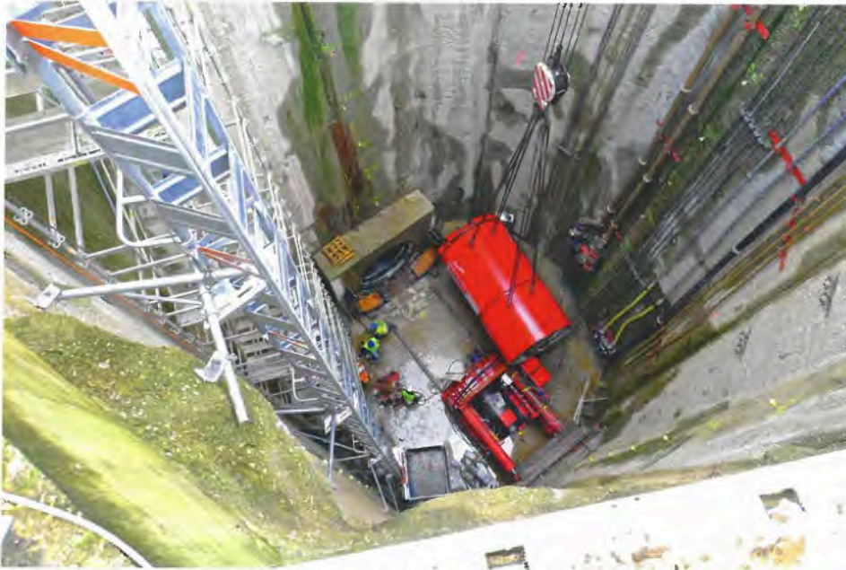
Auf der 27 m tiefen Schachtsohle wird die Vortriebsmaschine „Anita“ für ihren Einsatz eingeschwenkt.
