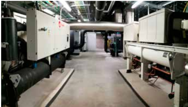
Smet-GWT heeft alle expertise in huis om de bronnen te boren, de borden te bouwen en de volledige elektromechanische installatie te plaatsen.
