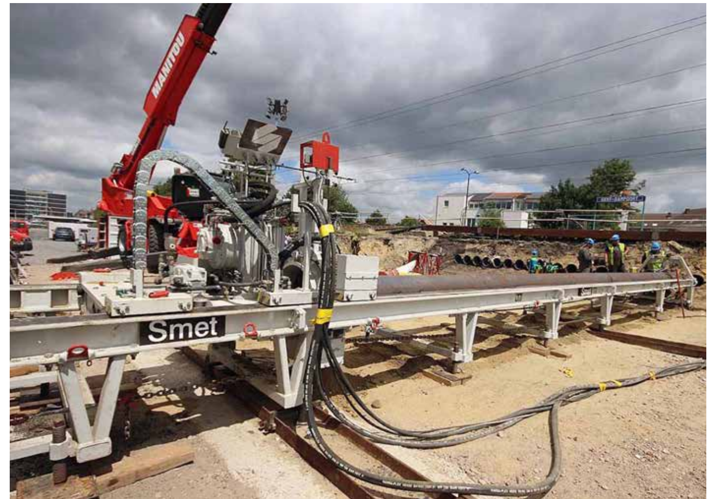
Een dakplaat, bestaande uit 20 naast elkaar liggende en onderling verankerde stalen buizen, werd in de grond aangebracht zonder de bovenliggende grond af te graven.
