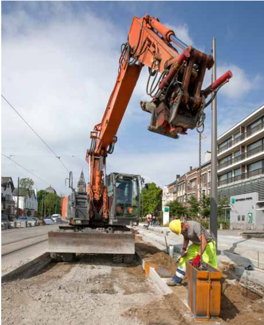
Gedurende de werken bleef het tramverkeer gewoon doorgaan, ook al moest de trambusbaan volledig vernieuwd worden.
