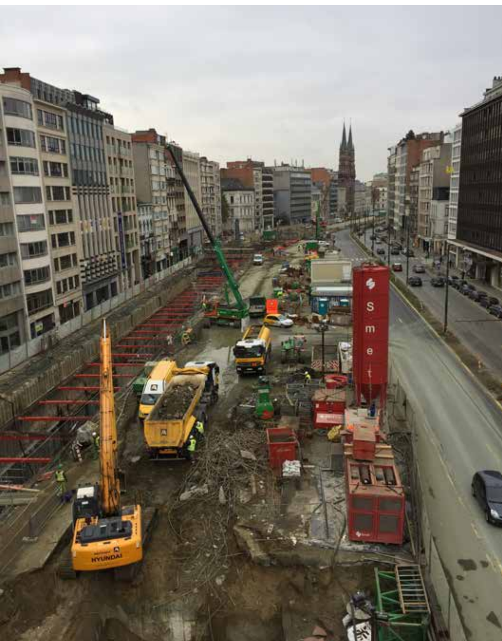
Hakron levert de toebehoren voor de betonbekisting van de tramtunnel en twee autotunnels onder de Antwerpse Leien.
