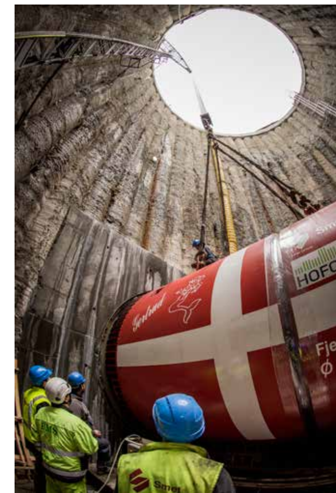
Via microtunnelling met gesloten frontboorsysteem creëerde Smet Group een nieuwe onderdoorgang voor de warmtevoorziening van Kopenhagen. (Foto: Jens Panduro)
